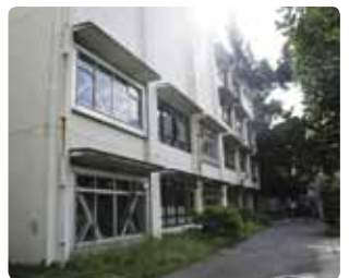
「老朽化を感じる建物は？」という質問で73人中25人が名前を挙げた駒場7号館。ちなみに2位は1号館でした。
