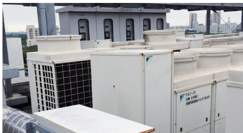
大学に多く存在する空調機（写真：先端生命科学研究棟）
