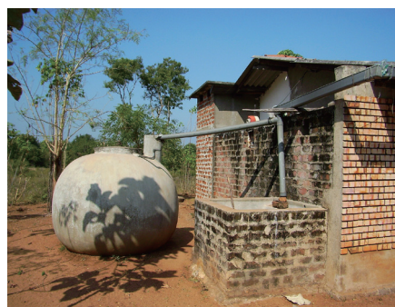
図2 水道の無いスリランカ農村家庭の雨水貯留タンク
