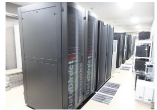
図3 運用改善を行ったサーバ室
