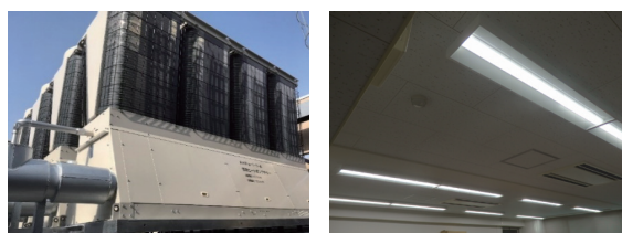
図3 省エネの設備更新対策 左：大型空調熱源設備の更新後、右：Hf照明のLED化後
