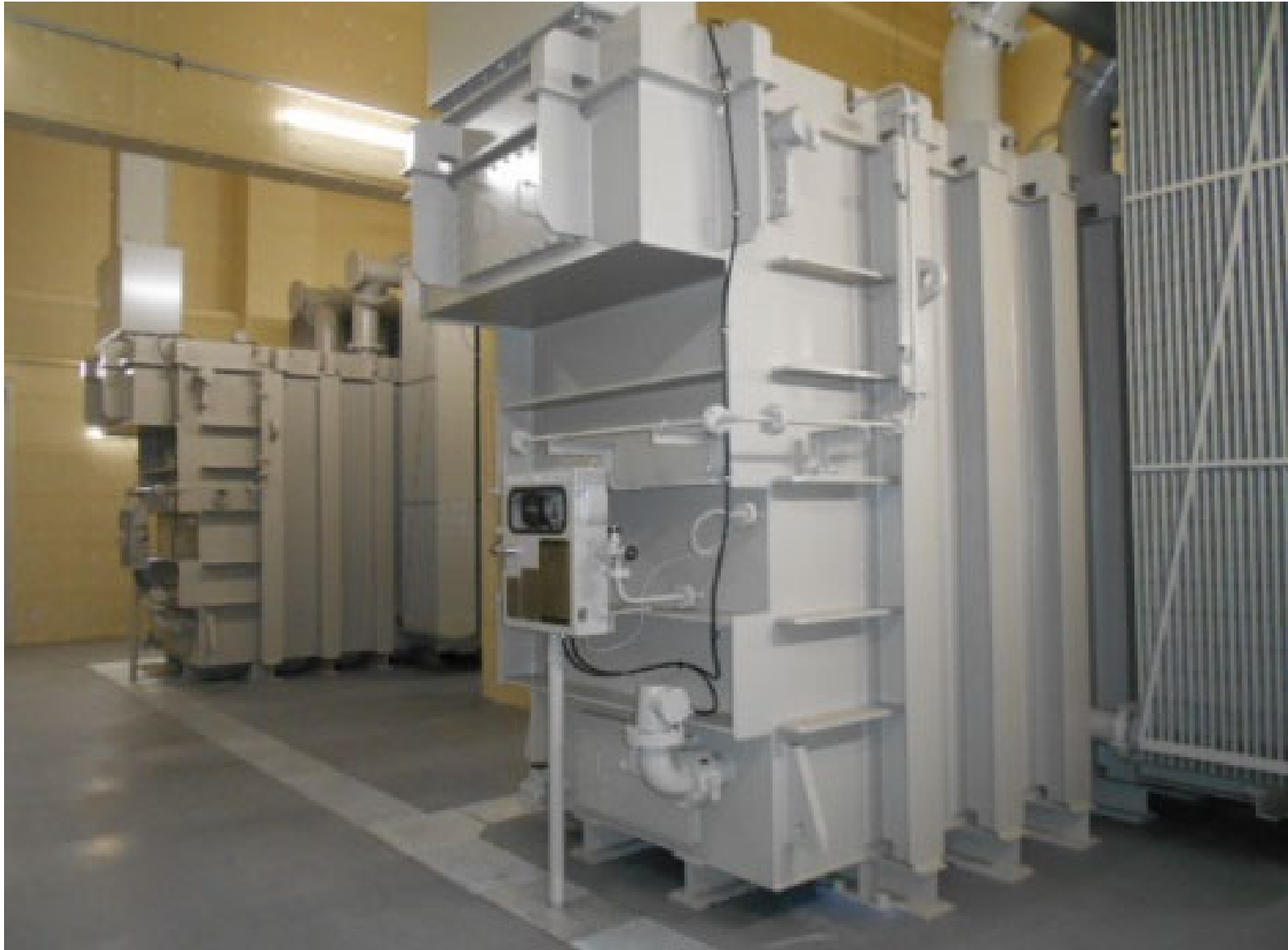
特高変圧器室
