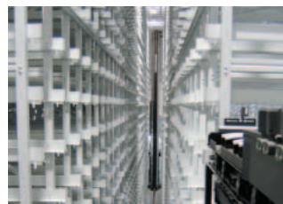
自動化書庫内部(スタッカークレーン)
