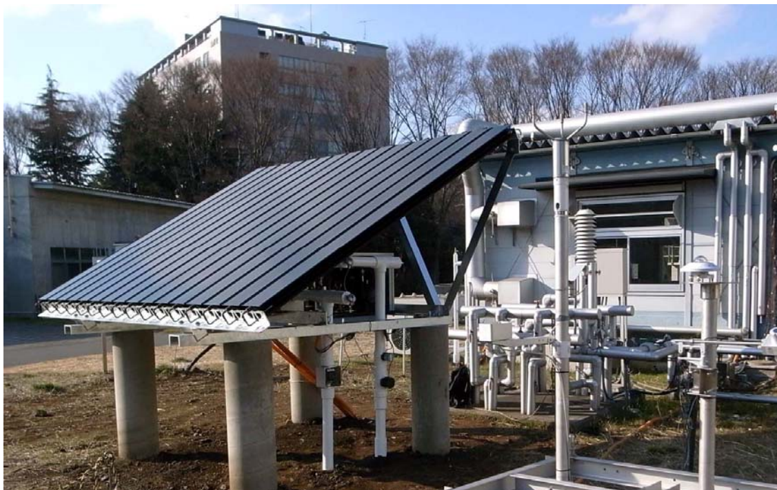
図2 実験システム（手前はソルエアヒートポンプ試作モジュール）
