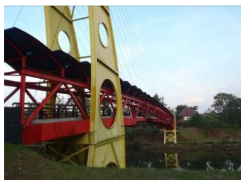
TEKSUS Bridge 工学系側から撮影
