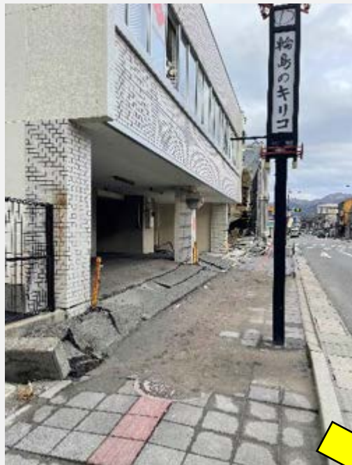
隣の建物前で液状化による噴砂を確認
