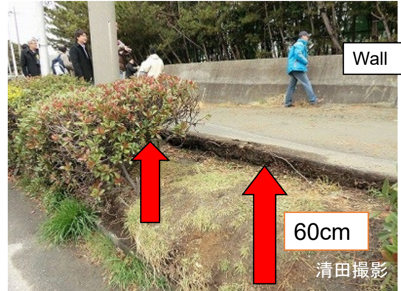
東北地方太平洋沖地震で確認された揺動現象に伴う歩道の隆起
