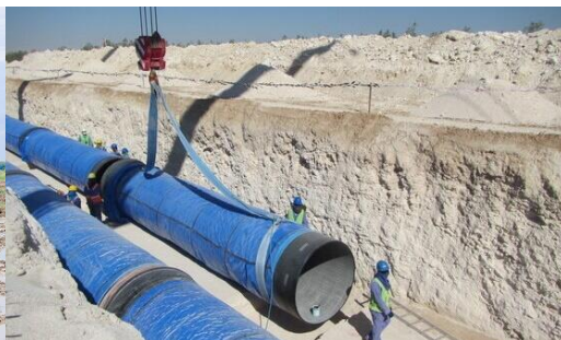
■ 水：カタル 約480kmの水道管
