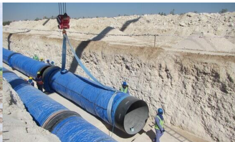
■ 水：カタル 約480kmの水道管
