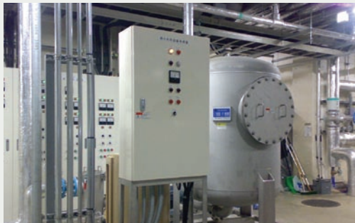
工学部新2号館 雨水再利用前処理装置
