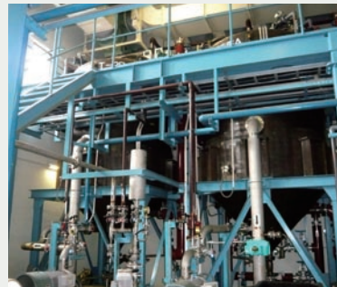
少量で多種多様な実験廃液を処理するために、無機系の廃液は主にフェライト法によって無害化しています(本郷キャンパス)
