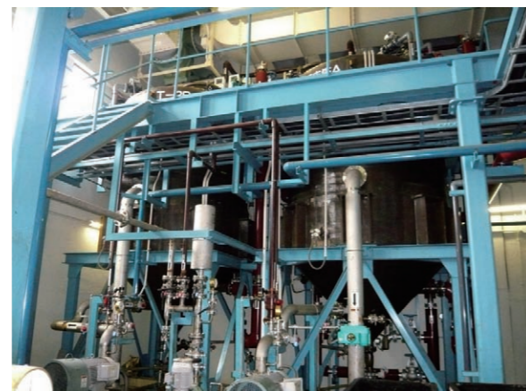
無機系廃棄物の学内処理設備 少量で多種多様な実験廃液を処理するために、無機系の廃液は主にフェライト法によって無害化しています（本郷キャンパス）
