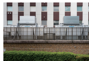
図2：水蒸発式間接外気冷却装置「Oasis」2基の外観。かなりの大きさです。
