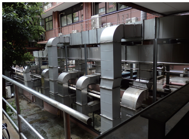
実験施設(ドラフトチャンバー)の排気ダクト
