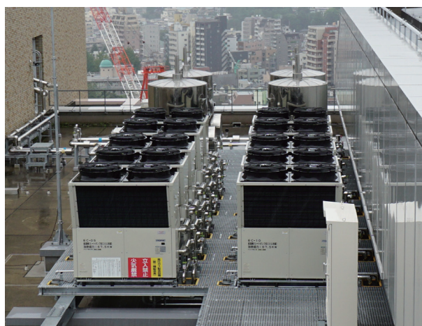
病院に設置した給湯用ヒートポンプシステム
