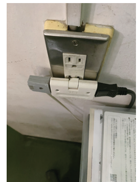
電源タップに破損がないか確認しましょう
