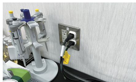
ホコリ蓄積防止のためのプラグキャップ装着例（好事例）
