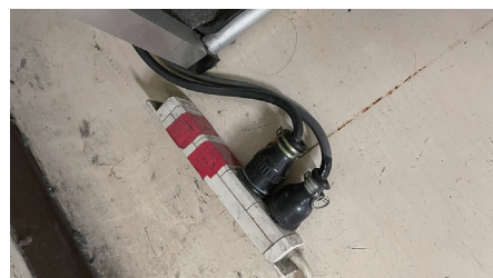
使用しないコンセント部の絶縁テープによるホコリや異物の侵入防止例（好事例）
